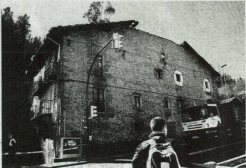
EN RUINAS. La vivienda de Ermua a la que se le derrumbó el tejado hace unas semanas. / A. L.
