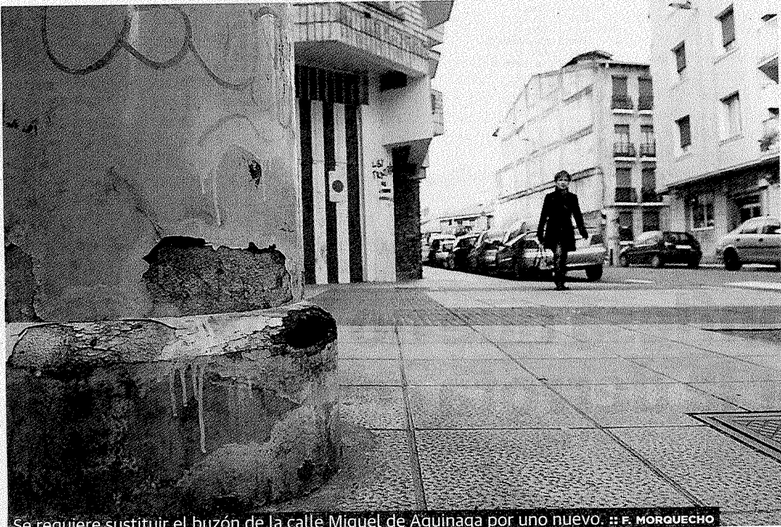
Se requiere sustituir el buzón de la calle Miguel de Aguinaga por uno nuevo. :: F. MORQUECHO
