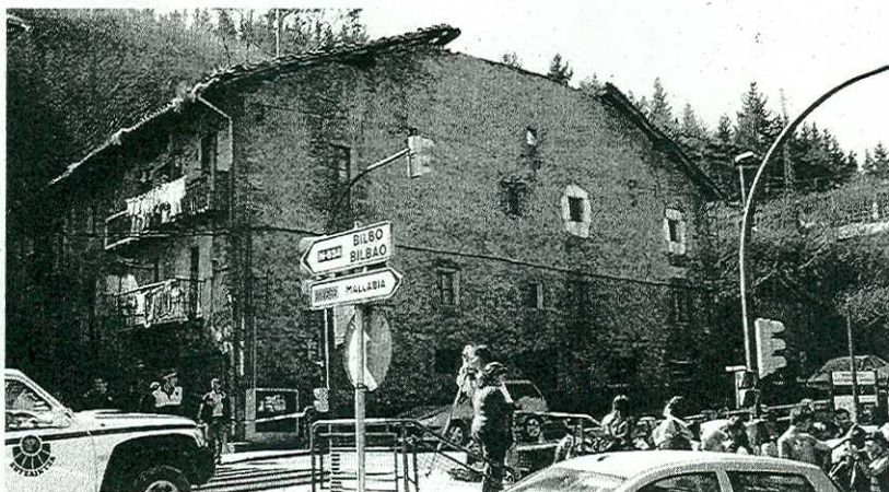
El tejado de la casa Kaltxango se vino abajo el viernes 13 de marzo en la avenida Bizkaia. FOTO: ERMUKO UDALA
